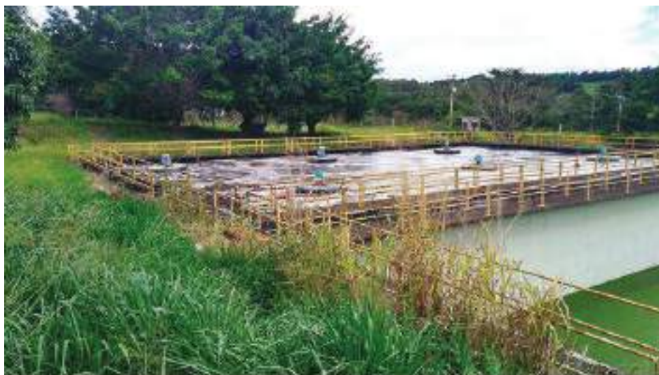
Figura 139 - ETE Jardim Luiza - Tanque de aeração 1.
