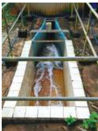
Figura 143 - ETE Jardim Luíza - Saída do efluente tratado.
