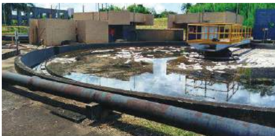
Figura 124 - ETE Franca – Setor 5 – Tanque de mistura.
