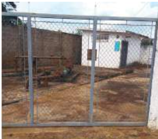
Figura 147 - ETE Santa Barbara II – Vista geral.
