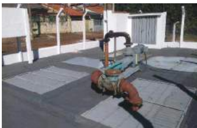
Figura 113 - EEE Palmeiras – Poço de sucção e bomba.
