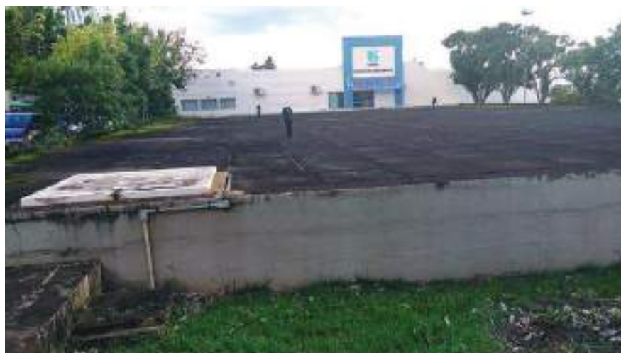
Figura 55 - Reservatório Enterrado RN1.
