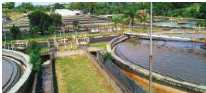
Figura 120 - ETE Franca - Setor 2 - Decantadores Primários 1 e 2.
