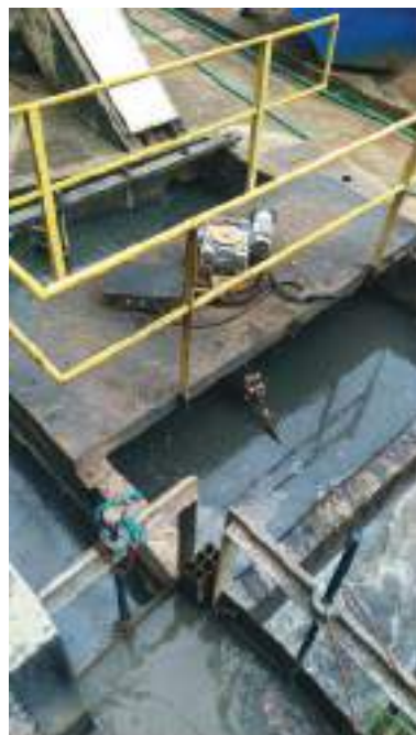
Figura 136 - ETE Jardim Luiza - Caixa de areia automatizada.
