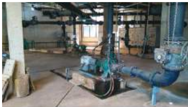
Figura 125 - ETE Franca - Setor 5 - Bombas de homogeneização.
