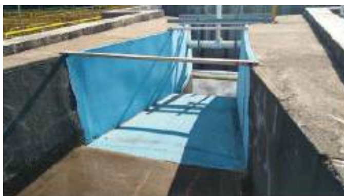
Figura 103 - ETA - Calha parshall.
