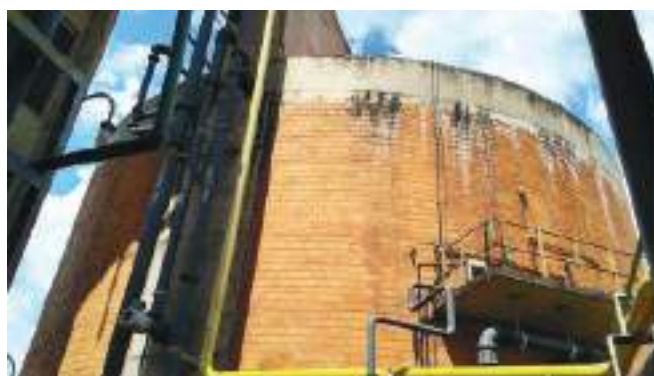
Figura 127 - ETE Franca - Setor 5 - Digestor secundário.
