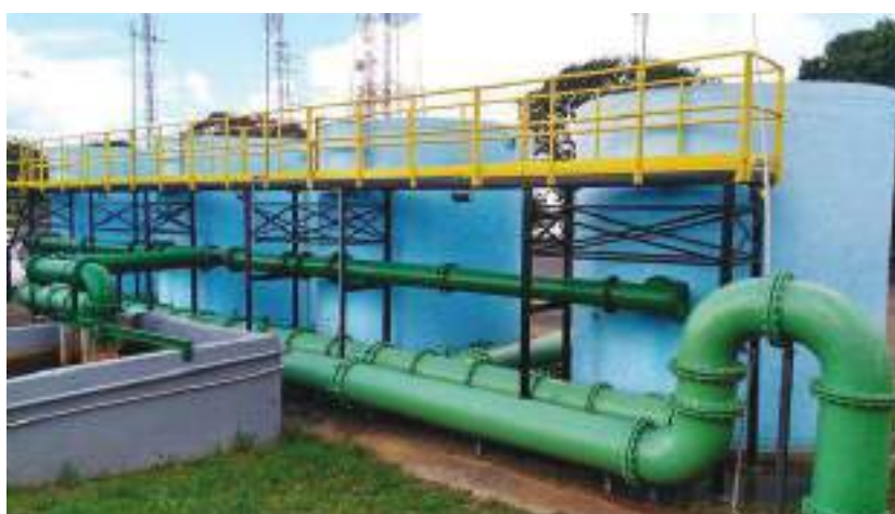
Figura 51 - ETA - Filtros - 4 filtros em fibra de vidro.
