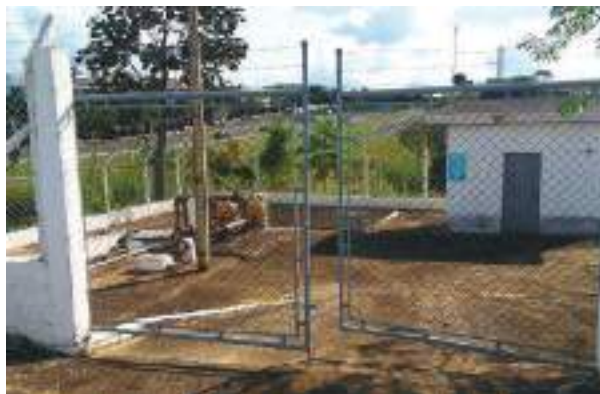
Figura 109 - EEE San Diego - Vista geral.
