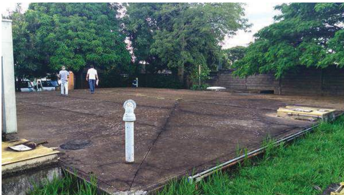
Figura 57 - Sistema ETA (Setor I) - Reservatório Enterrado R0
