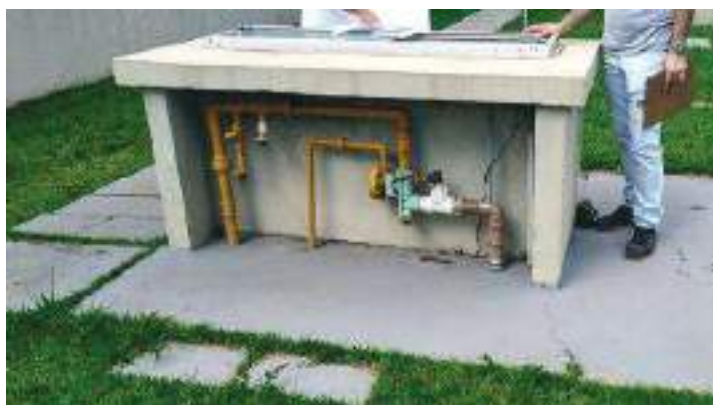
Figura 53 - ETA - Caixa de Reunião de Água Tratada.
