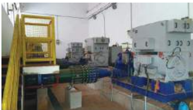
Figura 98 - EEAB 2 - Casa de bombas.
