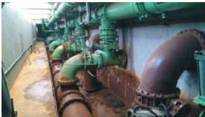
Figura 52 - ETA - Sistema de Lavagem dos Filtros.
