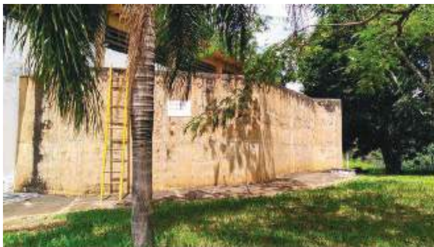
Figura 35 - EC2 - Poço de sucção – Vista geral.
