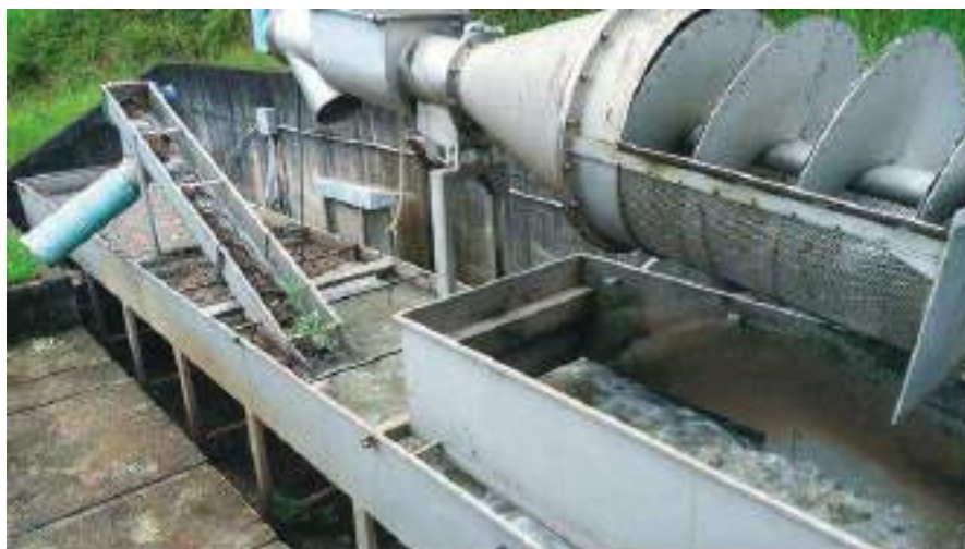
Figura 137 - ETE Jardim Luiza - Caixa de areia 2 (automatizada).
