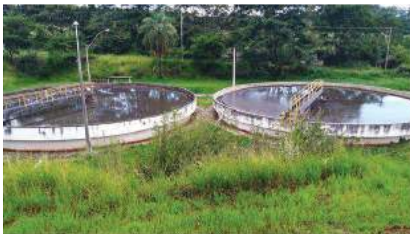
Figura 141 - ETE Jardim Luiza - Vista geral dos decantadores.
