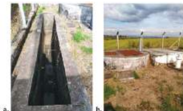
Figura 145 - ETE Aeroporto – Gradeamento, caixa de areia (a) poço de sucção (b).
