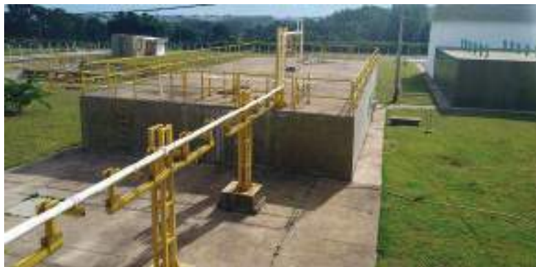
Figura 105 - ETA - Tanque de contato.
