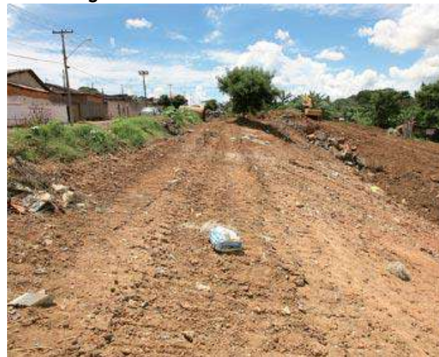
Figura 15: Erosão em Rua de Franca
