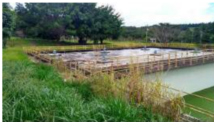
Figura 3.5.3(29) - Tanque de Aeração
