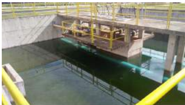
Figura 3.5.2(41) – Decantador da água de lavagem dos filtros e reuso de água para lavagem dos filtros.
