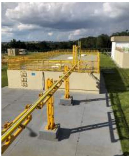
Figura 3.5.2(40) - Tanque de contato
