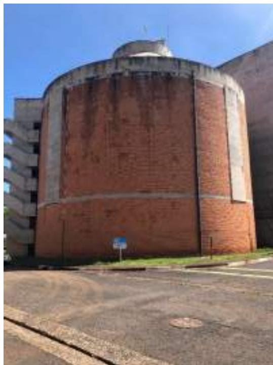
Figura 3.5.3(20) – Digestor de Lodo
