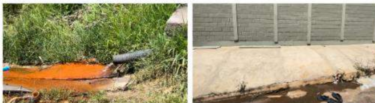
Figura 5.1(18) - Registros fotográficos de vazamento de água na EEAB-2, obtidos durante uma vistoria.
