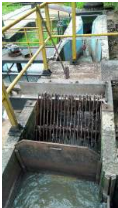
Figura 3.5.3(27) - Grade Grossa e Calha Parshall
