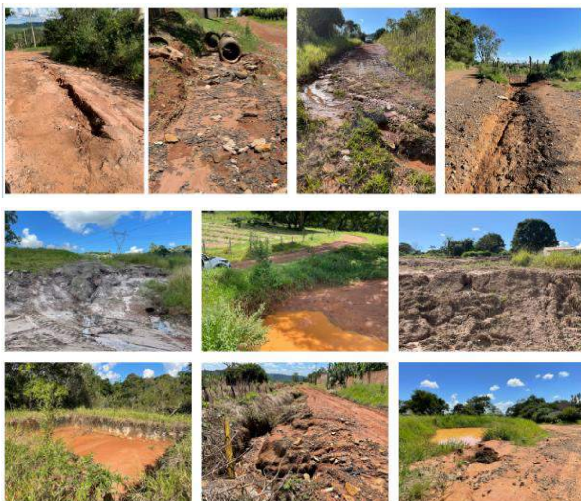
Figura 5.1(3) - Seleção de registros fotográficos de situações encontradas na bacia hidrográfica do Rio Canoas sobre drenagem, escoamento superficial e erosão.
