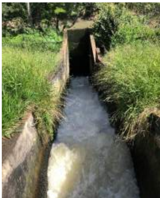
Figura 3.5.3(25) – Saída da ETE em direção ao Ribeirão dos Bagres
