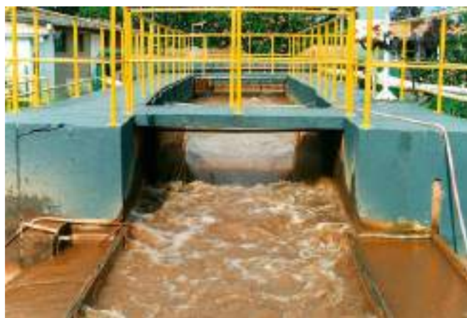
Figura 3.5.2(25) – Medidor Parshall de vazão – adição de produtos químicos
