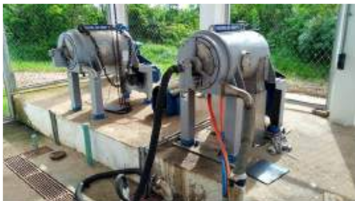
Figura 3.5.3(32) - Centrífugas para desaguamento do lodo
