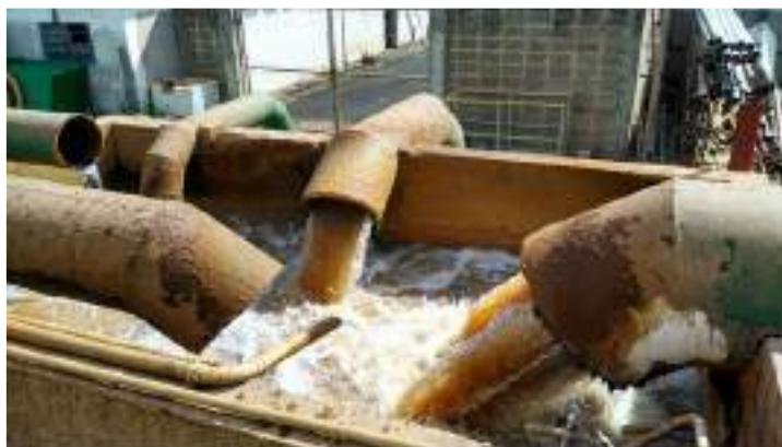
Figura 3.5.2(24) – Chegada da água bruta a ETA
